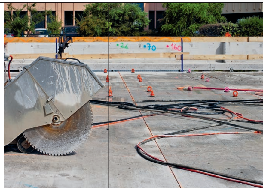
Renens, projet MixCity, sciage d'une dalle en béton coulée sur place. Photo: Célia Küpfer, EPFL, 2023
