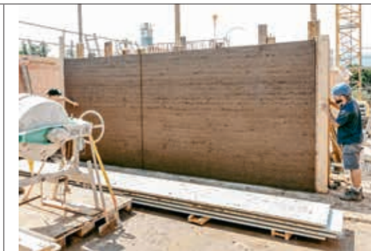
Athenaz (Avusy), quartier intergénérationnel d'habitations, construction d'un mur en pisé, atelier paysage et architecture aapaar, 2025. Photo: Thimothé Beuret
